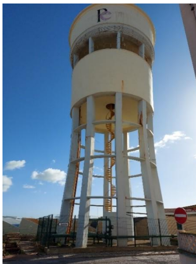
Reservatório Água (Parque Barreiro)
